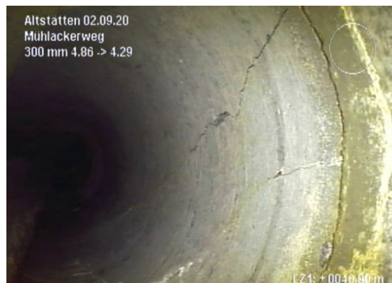
Längs- und Querrisse ca. km 0.142
