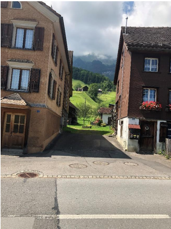
Von Kantonstrasse Blick gegen Fliessrichtung, km 0.230, Bach eingedolt
