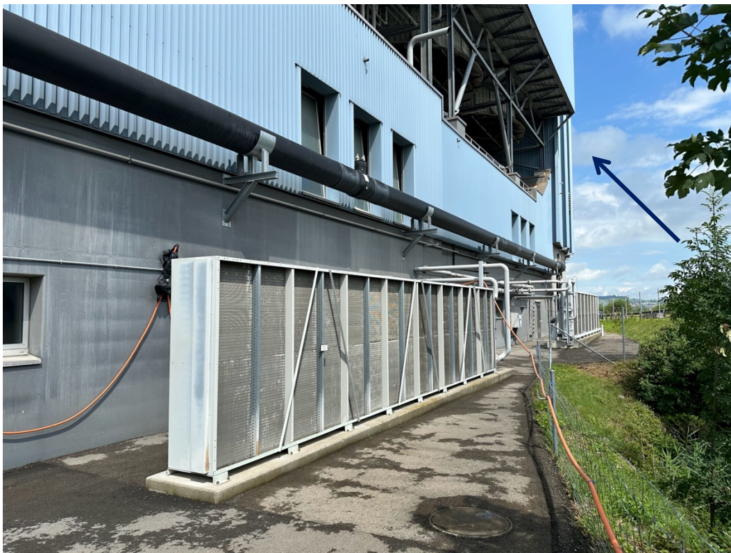
Abb. 19: Überkragender Bauteil mit Bestandesgarantie
