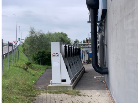
Kühlaggregate exponiert zur Umfahrungsstrasse
